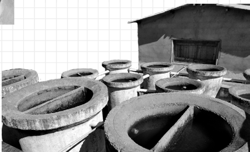
Floculadores e decantadores da ETA Jardim
