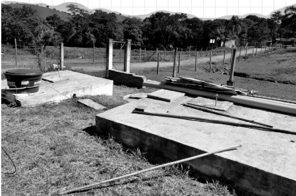
ETE Jardim (decantador primário e filtro anaeróbico)
