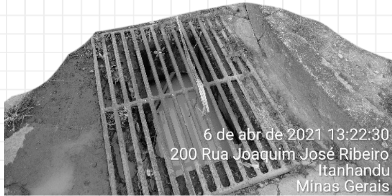
Retenção de água pluvial em bueiro
